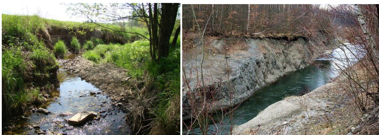
Obr. 39: Koryto je nadměrně zahloubené a po odnosu opevnění se dále zahlubuje (vlevo), extrémní případ nadměrného a pokračujícího zahlubování („kaňon“ Morávka - vpravo)
