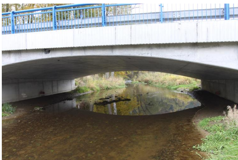
Obr. 49: Most s břehovými naplaveninami a přirozeným dnem je plně průchodný pro vydru i další semiakvatické druhy. Je plně průchodný i pro všechny druhy ryb.
