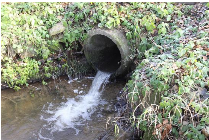
Obr. 46: Propustek vyústěný nad hladinou vody představuje úplnou protiproudovou migrační bariéru pro všechny druhy ryb.
