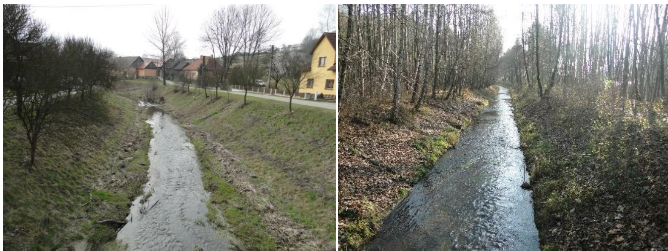
Obr. 37: Koryto je nadměrně zahloubené (vlivem technické úpravy) – intravilán (vlevo), extravilán (vpravo)
